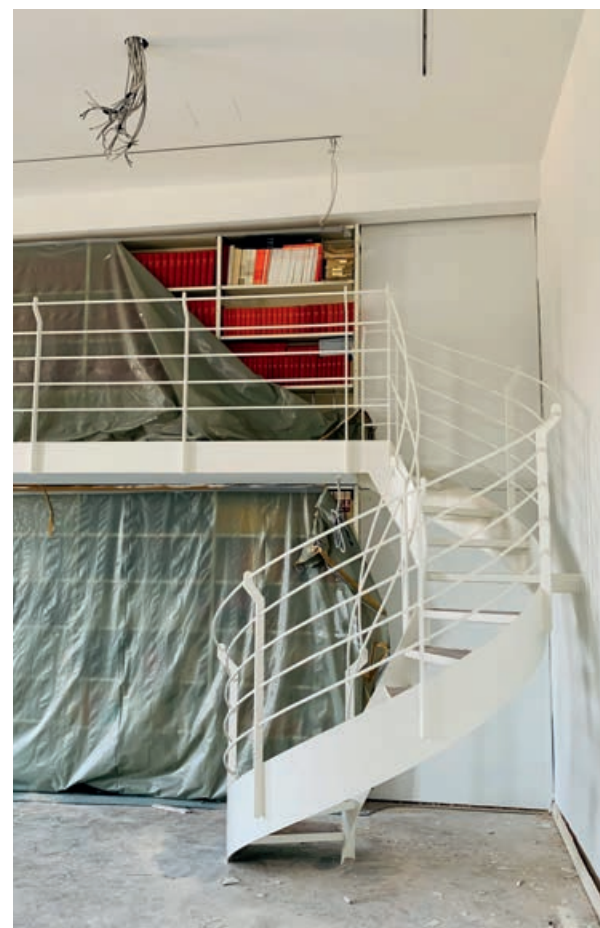
Bauarbeiter sind derzeit die häufigsten Gäste in der Bibliothek des Landeshauses. Die Renovierungsarbeiten starteten im Oktober letzten Jahres. Anfang April sollen die Buch-Bestände nach und nach zurückkehren, und ab Sommer soll die Bibliothek wieder nutzbar sein.
