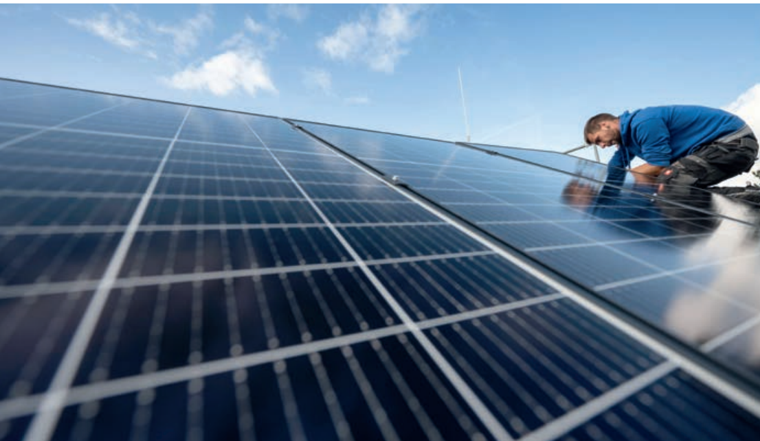
Sonne statt Kohle: Ein Arbeiter montiert Photovoltaikmodule auf das Dach eines Hauses.
