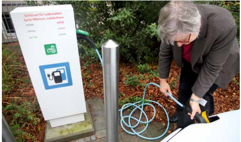
Strom aus der Steckdose statt Tiger im Tank: Eine Ladesäule für zwei E-Autos steht in Kiel zwischen Landeshaus und Finanzministerium.
